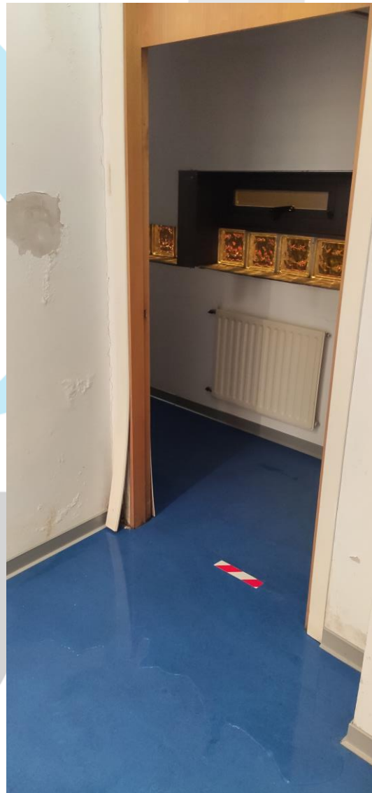
Acumulación de agua en el Suelo
